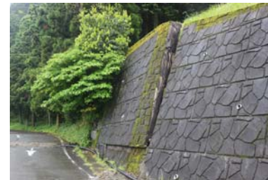
西原村 県道28号線 山留め擁壁
