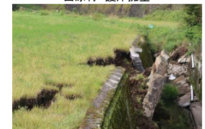
益城町下人陳 護岸擁壁
