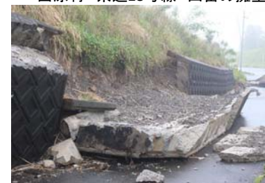
西原村 県道28号線 山留め擁壁
