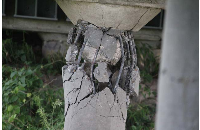
橋脚の柱頭部が座屈破壊 鉄筋は丸鋼、帯筋は非常に小さい
