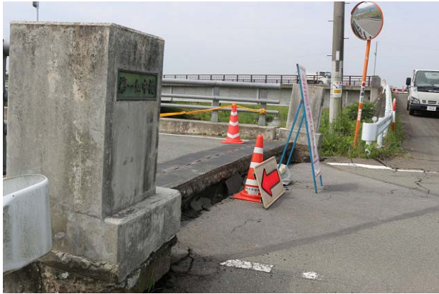
橋台背後の盛土が沈下し70cmの段差
