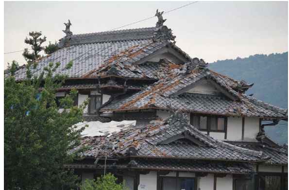
倒壊を免れた住宅
