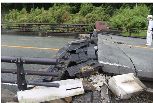
橋桁が約1.1m横移動、路面に40cmの段差
