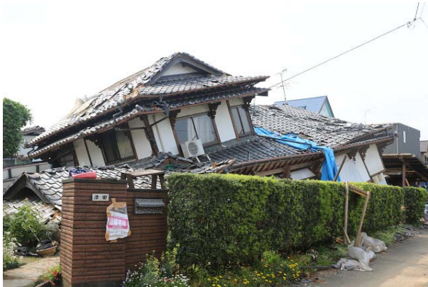
倒壊した住宅
