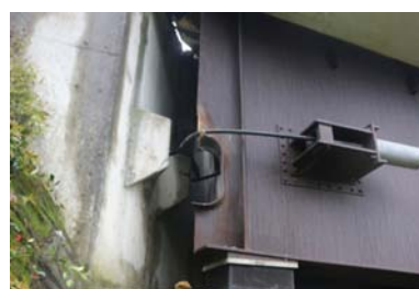
落橋防止ケーブルが破断
