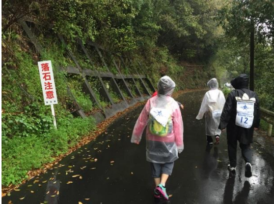
県道 340 号は落石危険箇所が多い。
