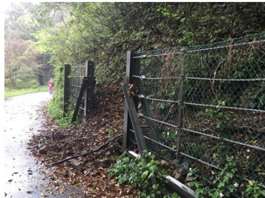
落石対策として道路際には落石防護柵が設置されているが、土砂の吐き出しのためだろうか1スパンだけ設置していない箇所がところどころ見られた。設置の仕方を誤っている。
