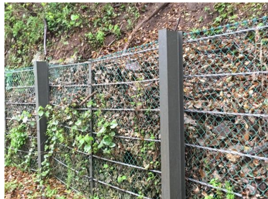
ズリが背後に堆積し、防護柵が擁壁としての機能を果たしていた。
