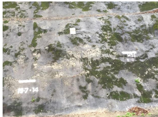
三里地区に来ると、四万十川の氾濫によって上昇した河川水位が、切土のり面の吹付コンクリートに表示されていた。
